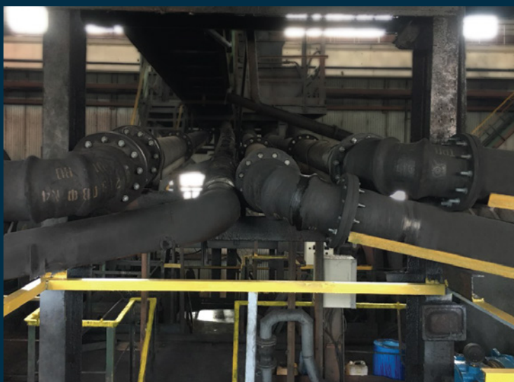
Трубопровод питания вакуум - фильтра ДОО-100. Горно - обогатительный комбинат
